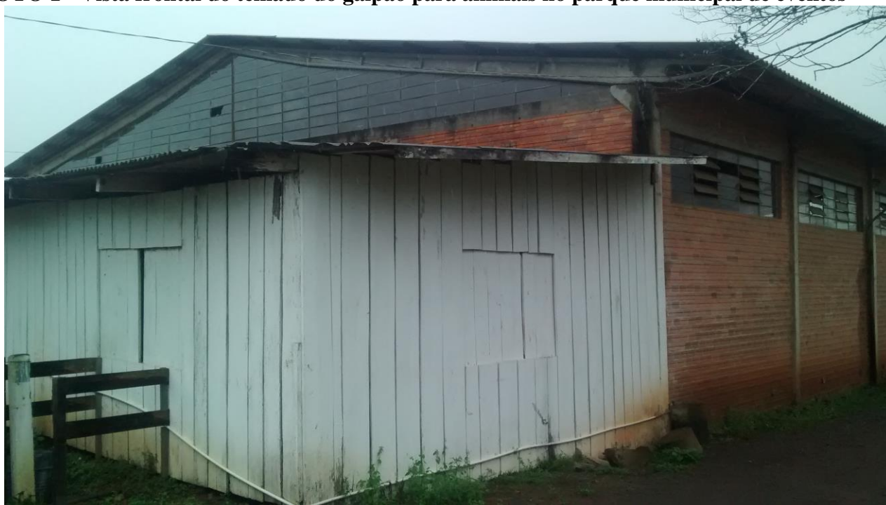
FOTO 2- Vista aproximada do telhado do galpão para animais no parque municipal de eventos
