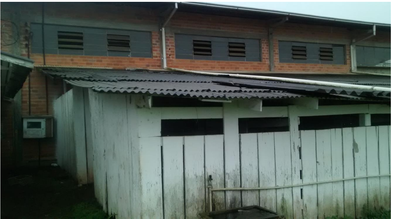
FOTO 2- Vista aproximada do telhado do galpão para animais no parque municipal de eventos
